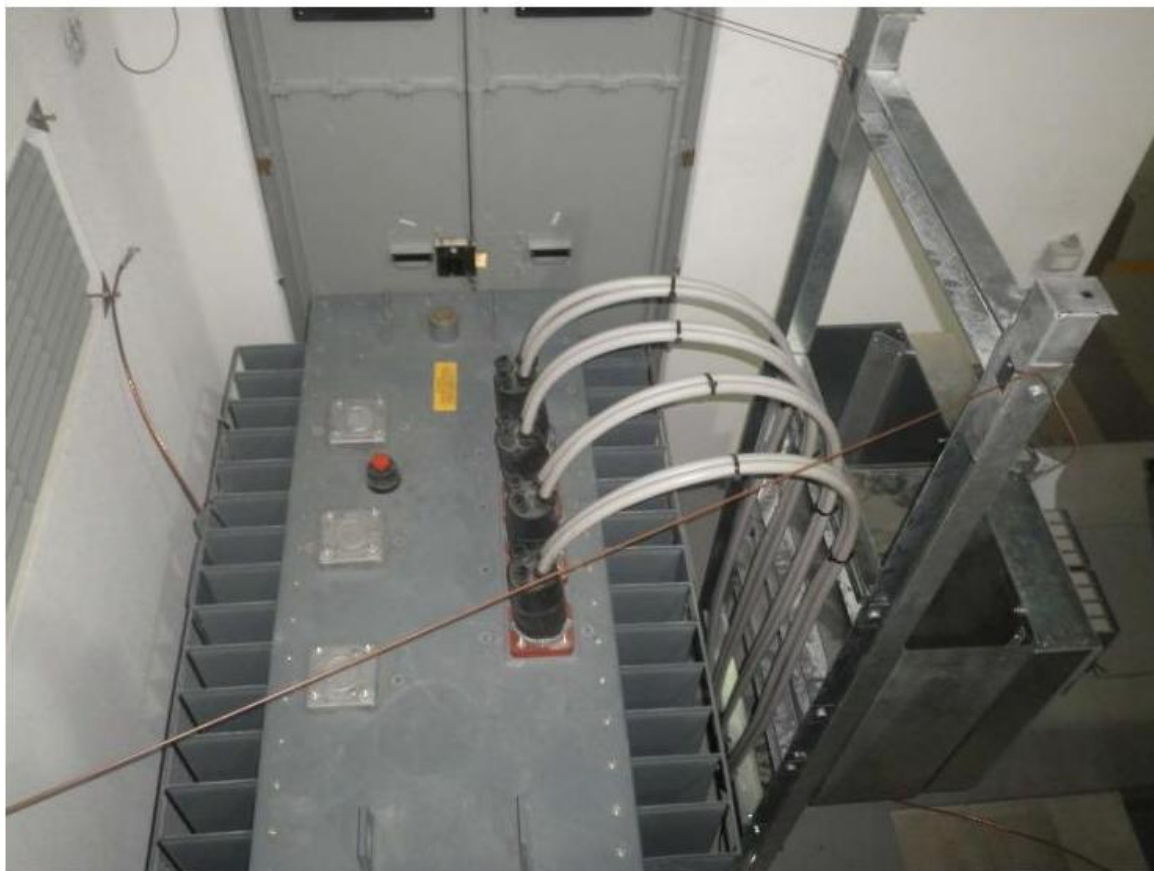
FOTOGRAFIA 1 si 2: Exemplu de montare Tablouri JT
