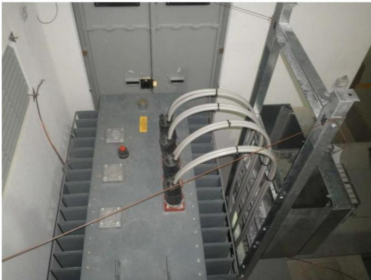
FOTOGRAFIA 1 si 2: Exemplu de montare Tablouri JT
